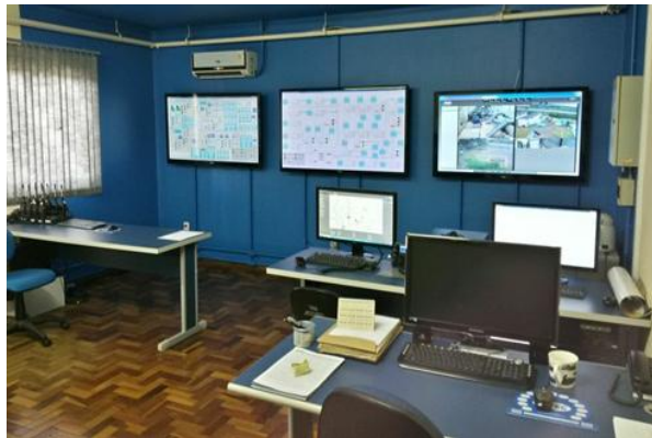
Figura 3. Centro de Controle Operacional de Canoas
