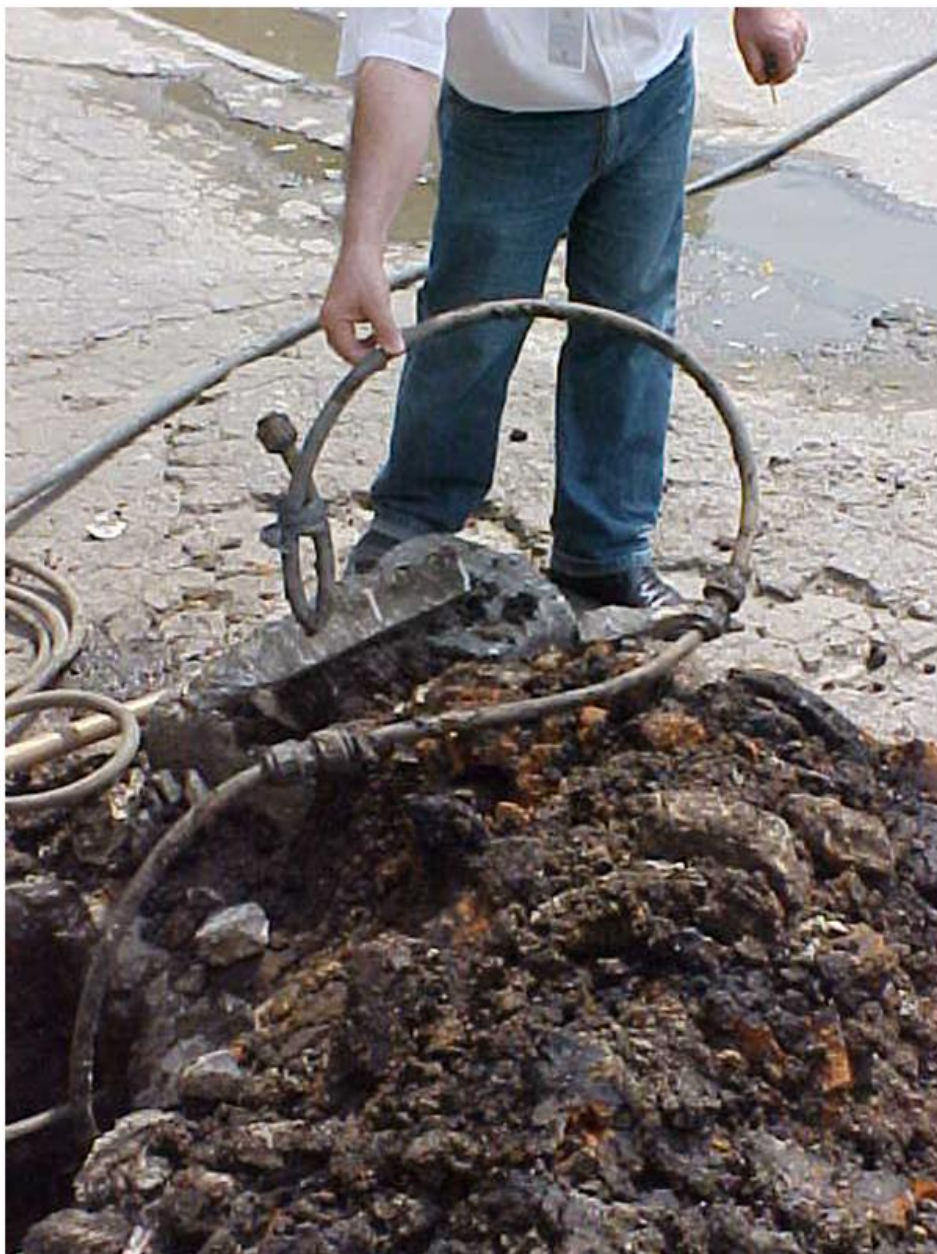
Foto 03 – Diversas Emendas em Ramal, Fonte: Sabesp
