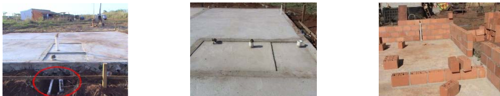
Figura 2: Detalhe das esperas de esgoto, com separação das águas cinzas e negras (fonte: Habis, 2007).
