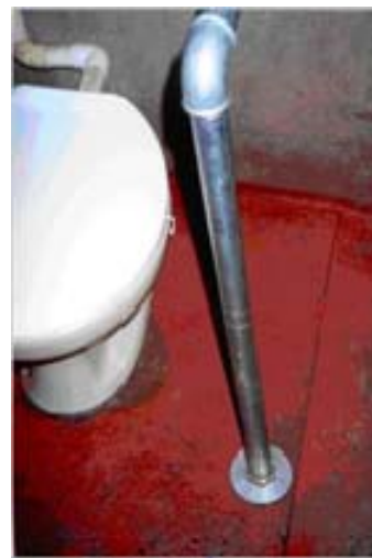
Figura 6: foto de barra instalada, próximo ao vaso sanitário. Fonte: VIZIOLI, 2003
