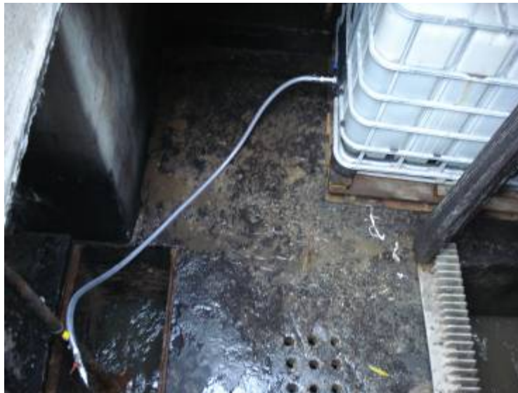
Figura 3: Tanque (IBC) de armazenamento do produto instalado na EE-A (Beira-mar).
