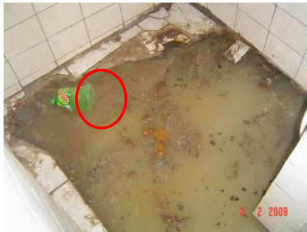
Figura 3 - Afundamento em banheiro
