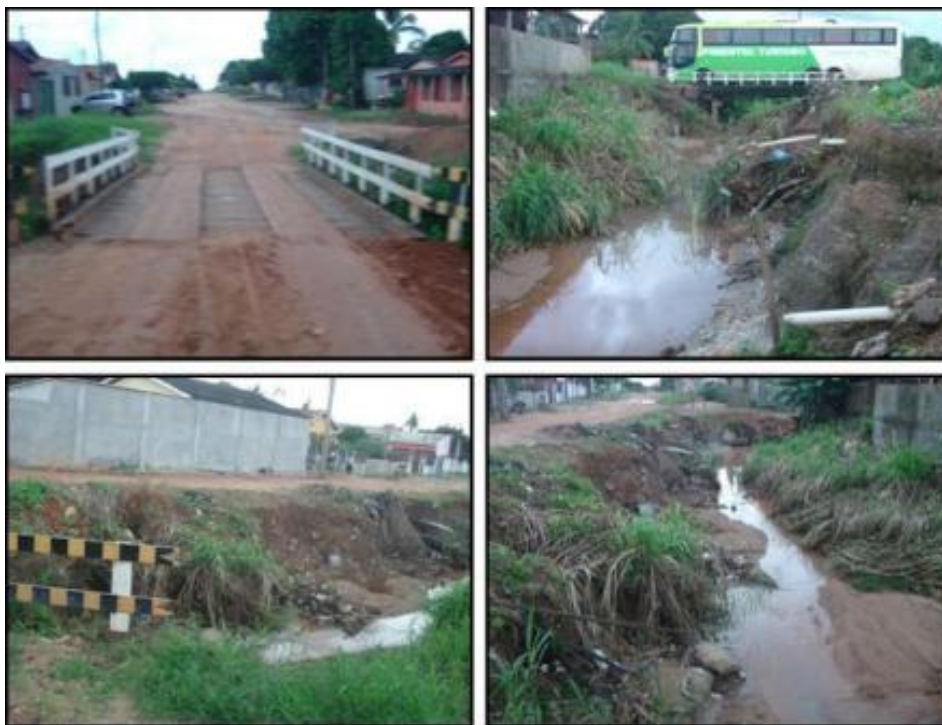
Figura 4: Assoreamento e deslizamento das margens do Igarapé Pintado.
