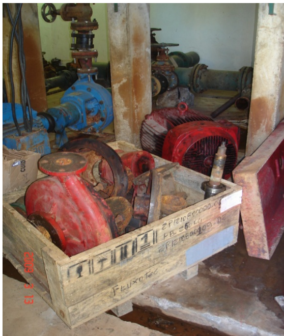
Figura 1: Precariedade dos grupos motobombas no primeiro levantamento.
