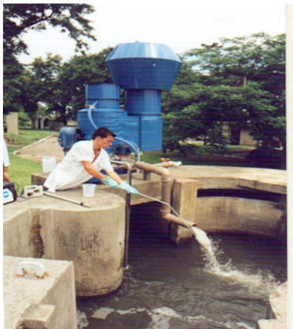
Figura 5 Centrifugação multiventuri de esgoto domiciliar na estação da Penha no Rio de Janeiro.
