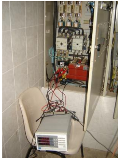
Figura 8. Wattímetro instalado no quadro de comando
