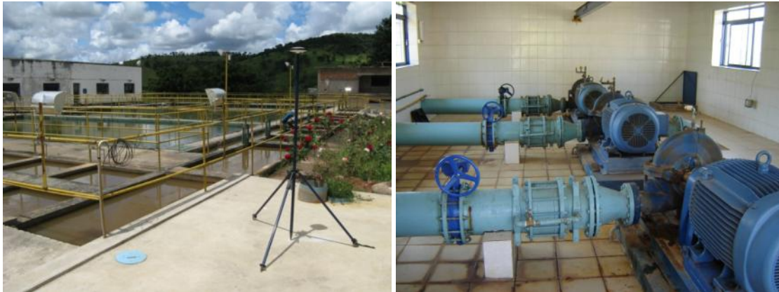
Figura 3. Estação de Tratamento de Água (ETA) e conjuntos motobombas da ETA.
