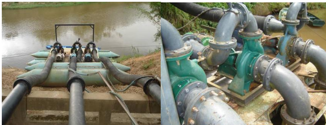
Figura 2. Conjuntos moto bombas da captação.
