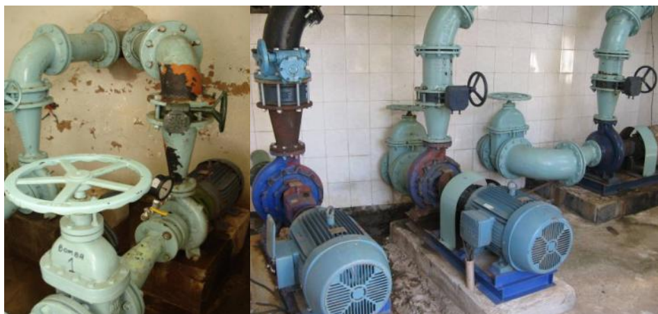
Figura 5. Conjuntos moto bombas do Jardim das Acácias (esquerda) e Carioca (direita).
