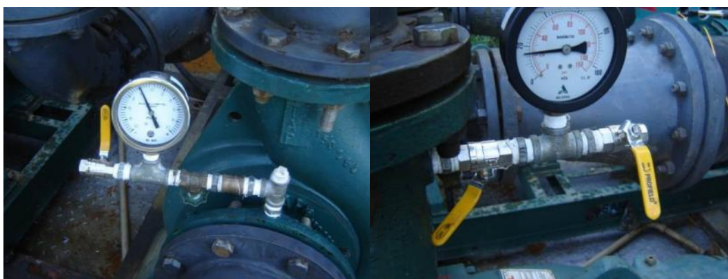
Figura 7. Medidas de pressão na entrada (esquerda) e saída (direita) da bomba.
