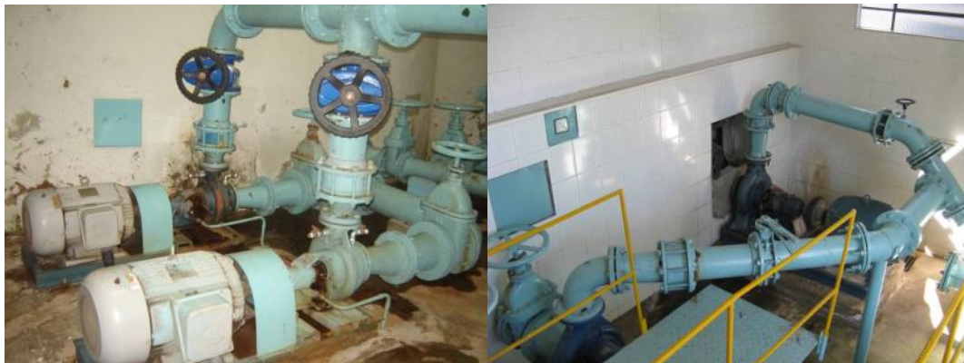
Figura 4. Conjuntos moto bombas do Solar dos Lagos (esquerda) e São Francisco (direita).
