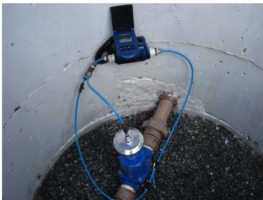
Figura 4: Válvula em Funcionamento
