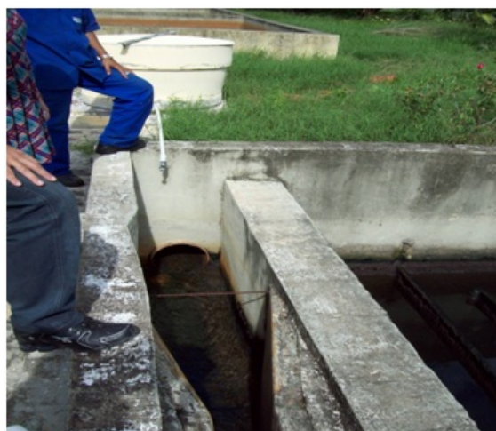
Figura 4: Processo de desinfecção na ETE Orlando Dantas (FREIRE, 2010).
