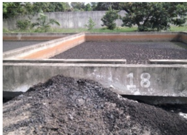
Figura 6: Leitos de secagem da ETE Orlando Dantas (FREIRE, 2010).
