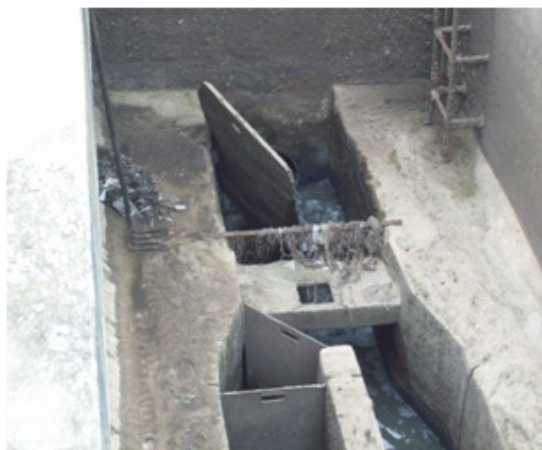
Figura 1: Pré-Tratamento da ETE Orlando Dantas (FREIRE, 2010).
