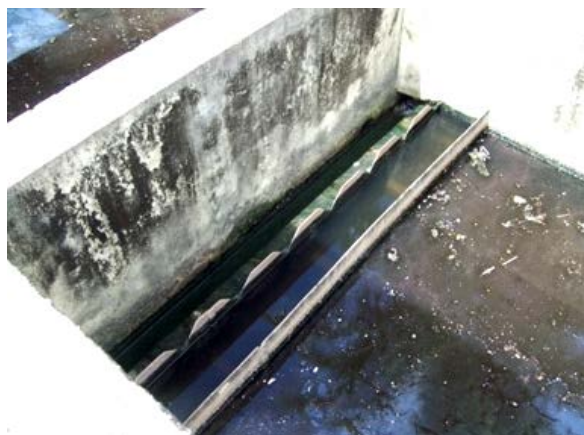
Figura 3: Decantador Secundário da ETE Orlando Dantas (FREIRE, 2010).
