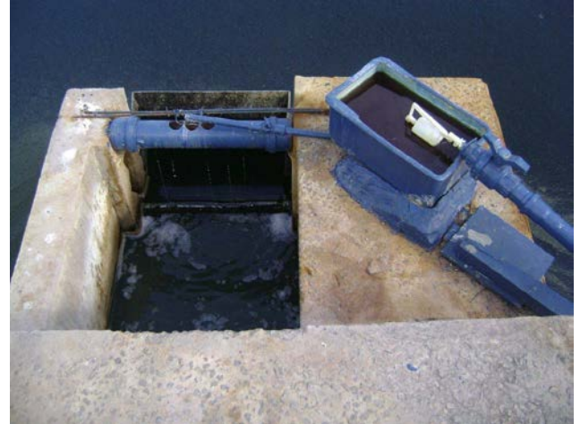
Figura 2: Equipamento para gotejamento de coagulante.
