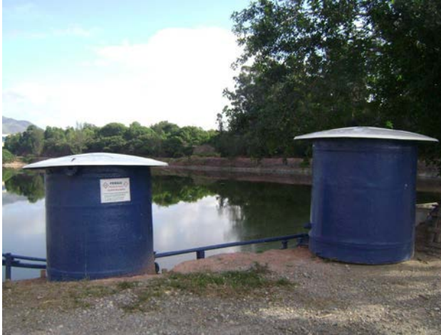
Figura 1: Tanques de armazenamento do coagulante.
