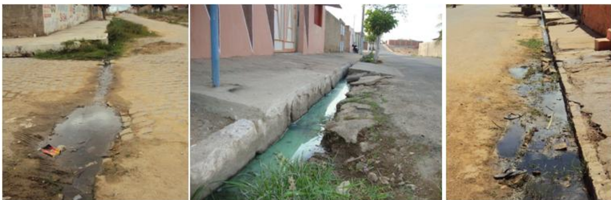
Figura 04: Situação da drenagem urbana no bairro Pedra do Lorde.
