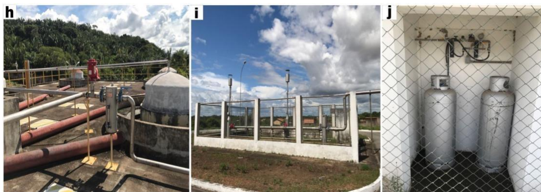
Figura 07: Processo de Coleta de Biogás (h), Câmara de Biogás (i) e armazenamento (j).
