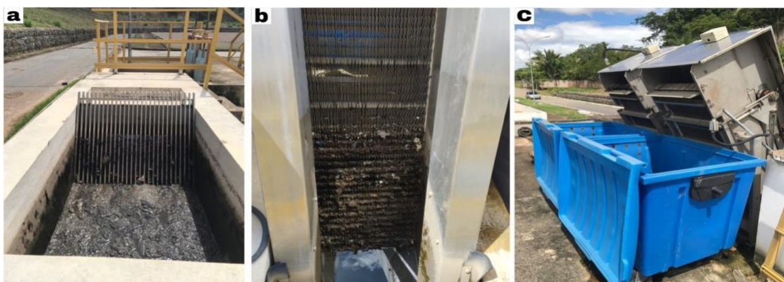
Figura 04: Tratamento Preliminar. Gradeamento (a) e (b), Resíduos (c).
