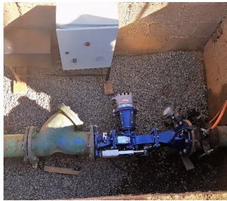
Figura 2 – Turbina Redutora de Pressão 2024
