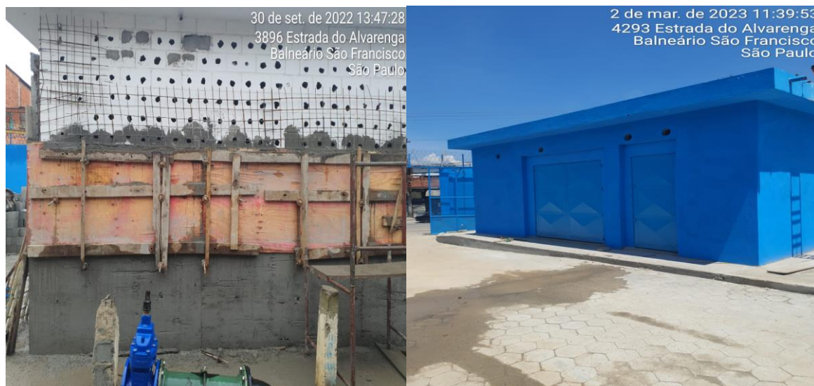
Figuras 1 e 2: Estação Elevatória Alvarenga 1 antes(vandalizada) e depois(recuperada)
