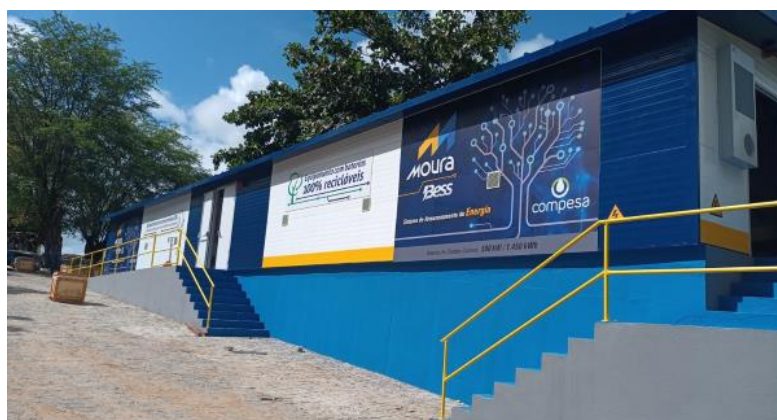
Figura 2 – Sistema BESS instalado na ETA Petrópolis
