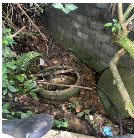
a) Poço de captação e distribuição de água
