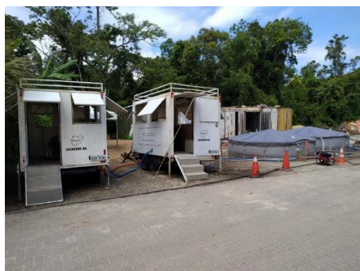
b) Unidade Móvel de Tratamento de Água – UMTA
