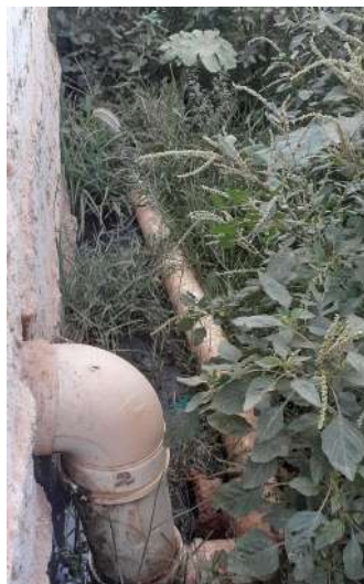
Figura 7. Tubulação de esgotamento sanitário.
