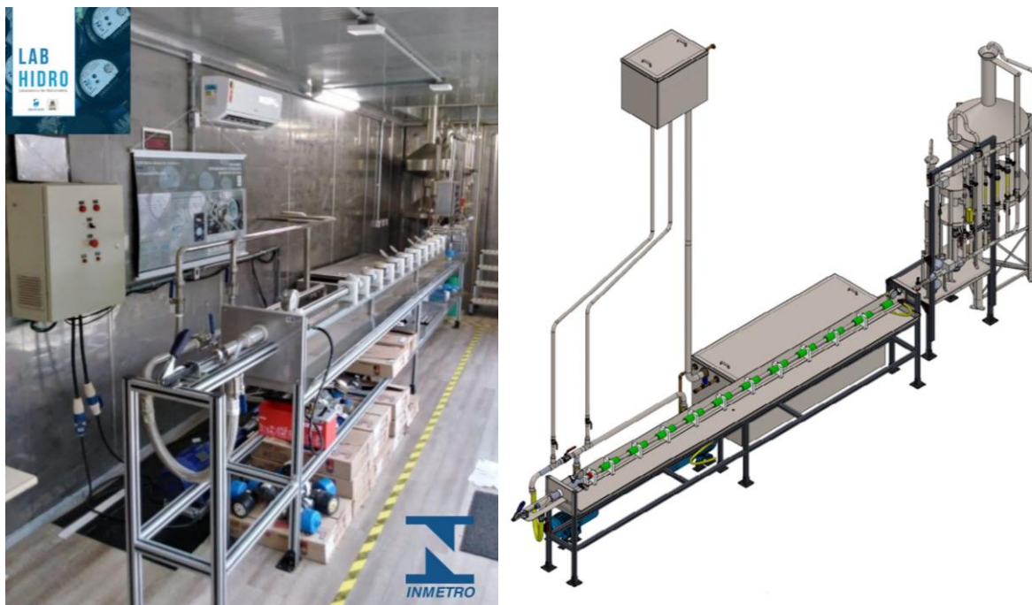
Figura 2: Laboratório de Hidrometria LabHidro da Companhia Águas de Joinville, e, Desenho Isométrico da Bancada de Aferição
