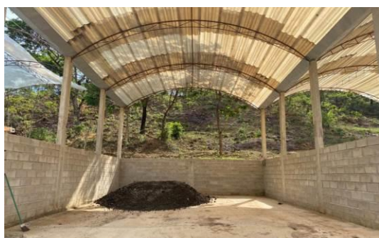
Figura 7 – Baia de higienização do lodo.
