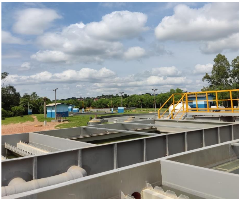
Foto 1 - ETE TIBAGI - Módulos físico químico FONTE: Autor ((2022))
