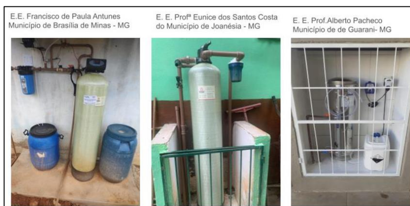
Figura 5: Sistemas de filtragem e cloração instalados nas escolas.
