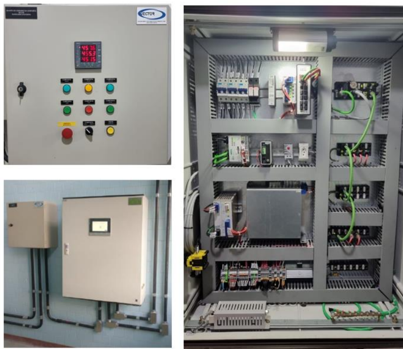
Figura 2 – Painel de Comandos Elétricos - PCE com Controlador Lógico Programável – CLP
