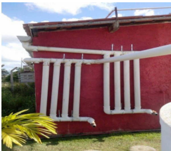
Figura 1: Dispositivo para desvio automático das primeiras águas de chuva – DESVIUFPE, 2017.
