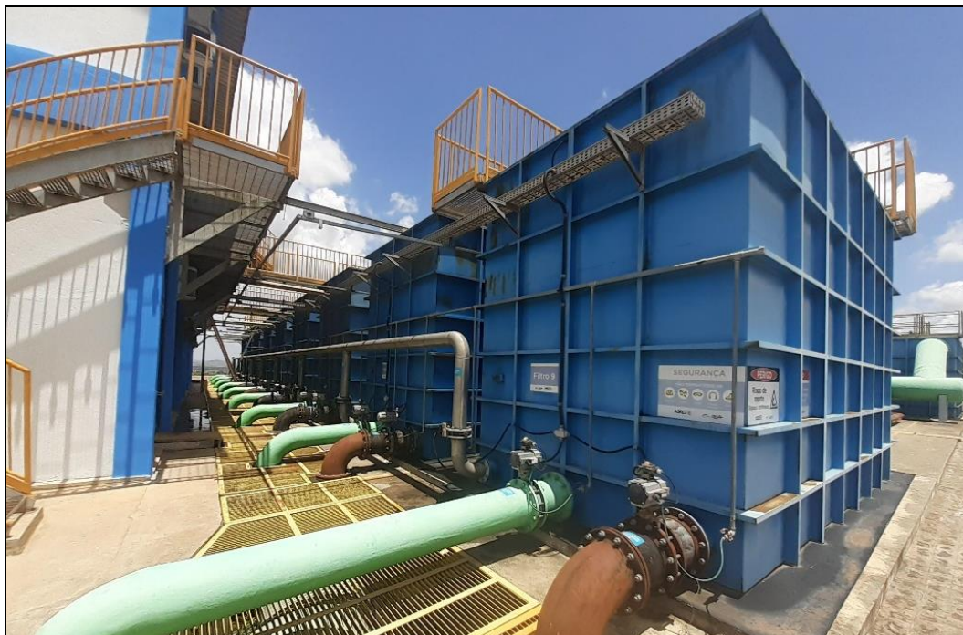
Figura 3: Filtros da ETA Arapiraca.
