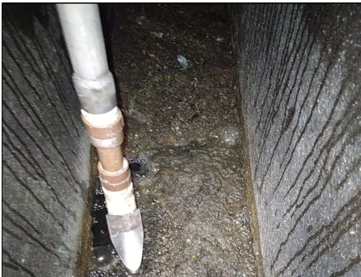
Figura 6: Sistema de aspersão no canal após a modificação.
