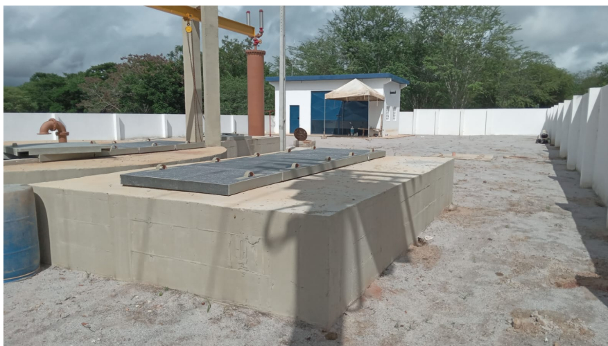
Figura 5: Foto da Estação Elevatória de Esgoto na Cidade de Senhor do Bonfim/Ba.
