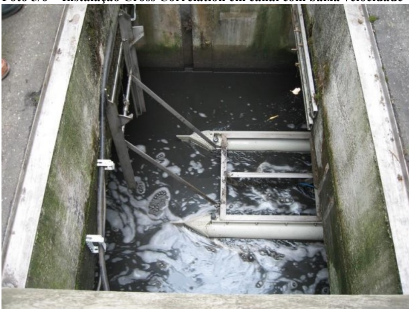
Foto 5/6 – Instalação Cross Correlation em canal com baixa velocidade
