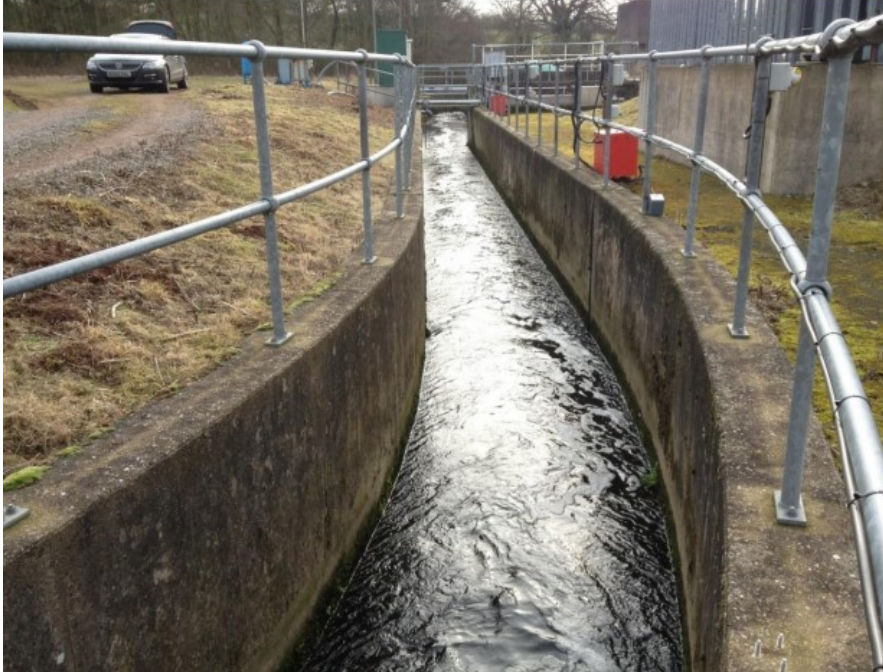
Foto 2/3 – Instalação Cross Correlation em canal de Estação de Tratamento de Esgoto
