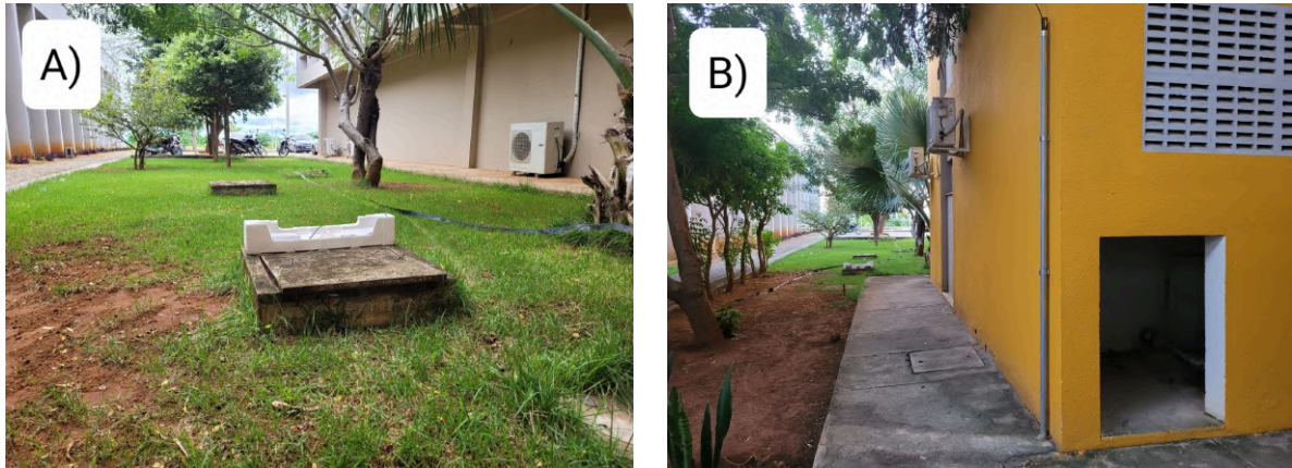
Figura 4: Sistema instalado em reservatório real. A) Instalação do protótipo em caixa de inspeção do reservatório. B) Localização do reservatório e da casa de bombas onde também está instalado um hidrômetro.
