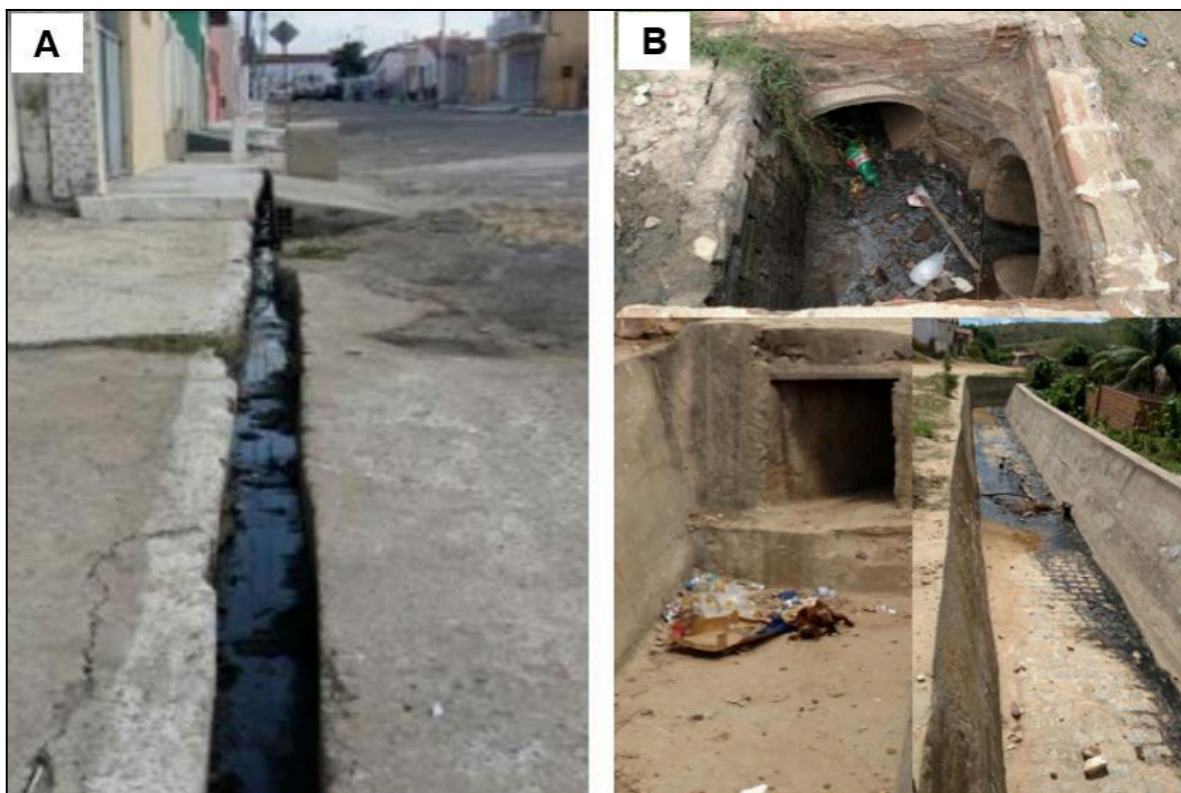
Figura 8: A) Lançamento de águas residuárias em sarjeta no município de Serra Caiada/RN. B) Presença de resíduos no sistema de drenagem de Bodós.
