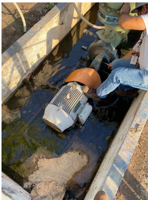
Figura 4: Imagem do alagamento no booster.
