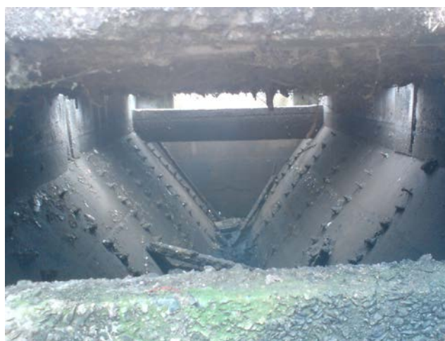
Figura 2: Vista interna de um TI
