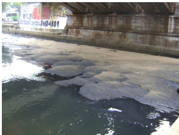
Figura 7 – Assoreamento de calha no Canal do Manguê
