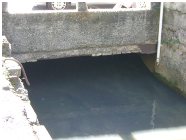
Figura 6 – Obstrução do escoamento da seção maior do rio Trapicheiros por viga de ponte Fonte: Otoni A, Destri A, Araújo M, 2010
