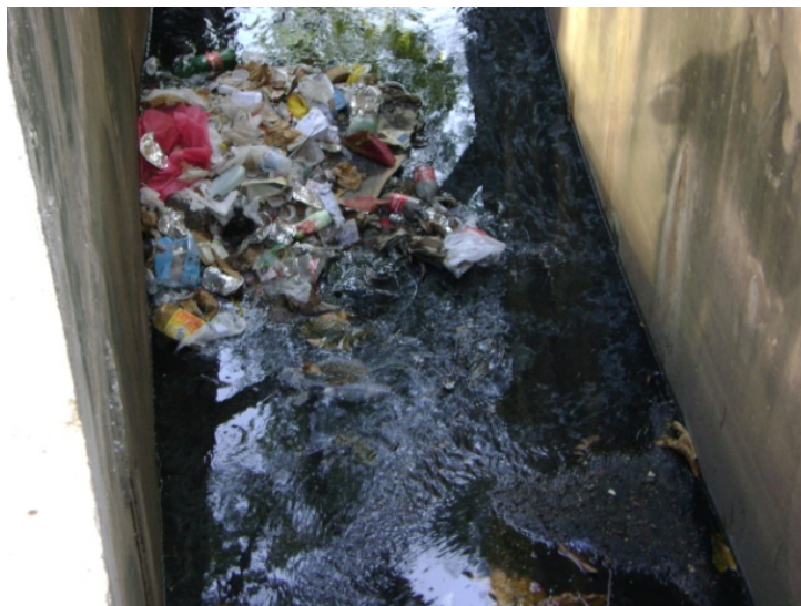
Figura 3 – Acúmulo de lixo nas calhas fluviais
