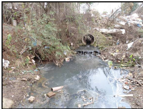
Figura 2. Lançamento de esgotos “in natura” na Vila Urlândia, “correndo” a céu aberto.
