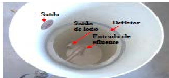
Fotografia 01: Demonstração da parte interna do reator UASB.
