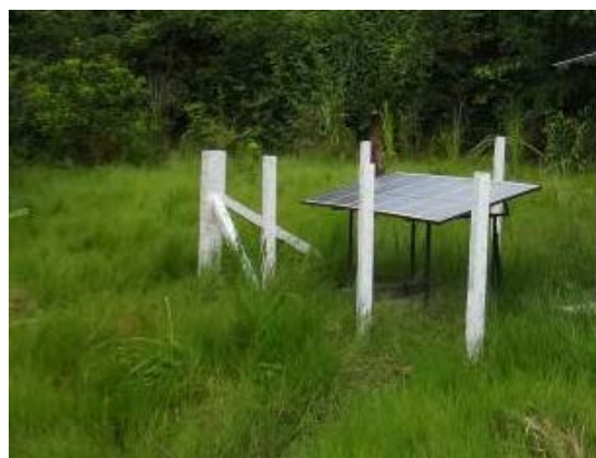
Figura 6: Painéis fotovoltaicos na aldeia Cafezal
