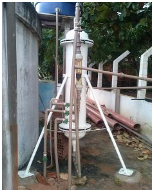
Figura 1 – Filtro Piloto instalado junto à ETA de Jericoacoara.
