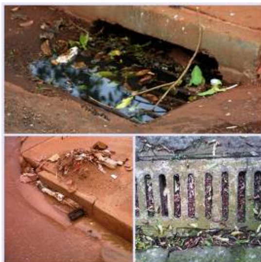
Figura 9: Bueiros e bocas de lobos obstruídos pelos resíduos (Arquivo Pessoal, 2013).
