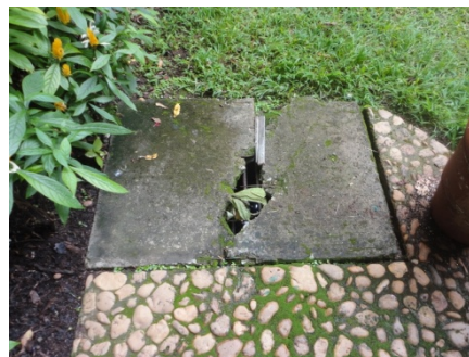
Figura 2: caixa de esgoto com tampa quebrada.
