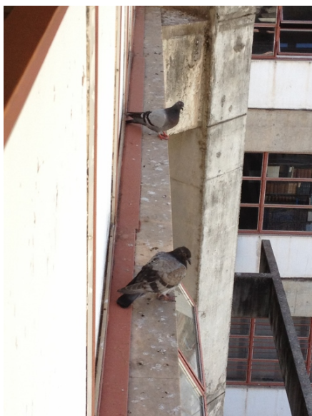
Figura 1: Pombos nas vigas
