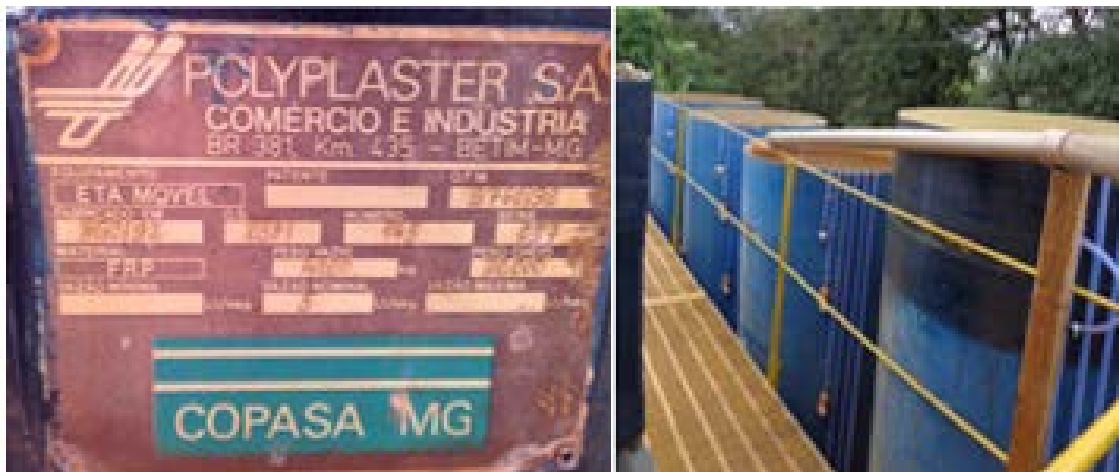
(a) Placa com informações da ETA
