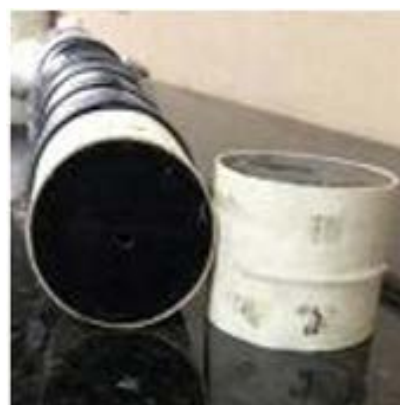
(b) Orifício dentro da tubulação
