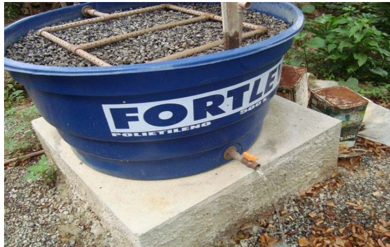
Figura 3: Tubulação de eliminação de efluente, localizado na parte superior da caixa, Campina Grande, 2012.
