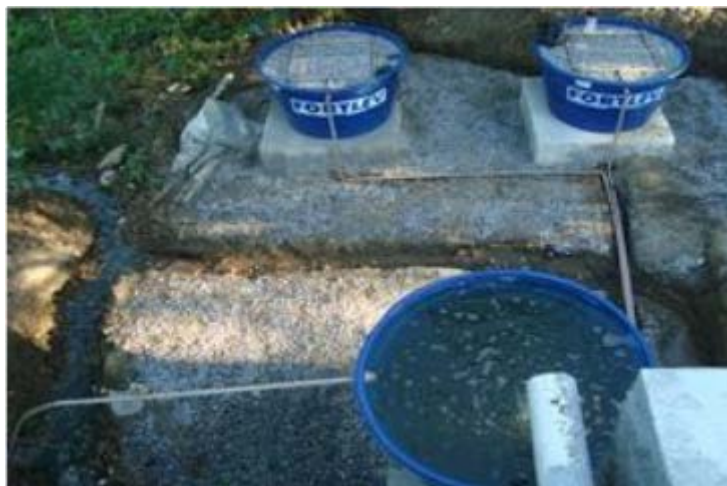
Figura 2: Tanque de equalização recebendo efluente do filtro anaeróbio.
