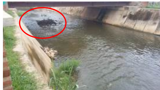
Figura 9. Canal de drenagem presença de resíduos de construção civil. Fonte: Autor.
