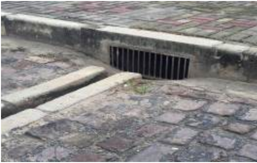
Figura 6. Boca de lobo com gradeamento. Fonte: Autor.
