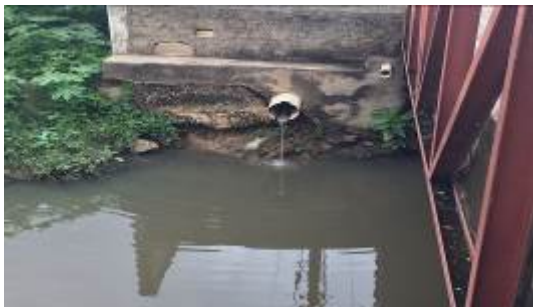
Figura 11. Lançamento irregular de esgoto doméstico em canal. Fonte: Autor.
