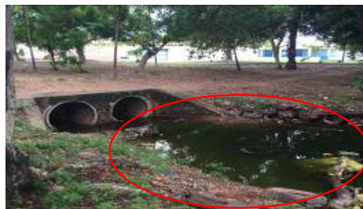
Figura 10. Bueiro recebendo resíduos sólidos. Fonte: Autor.
