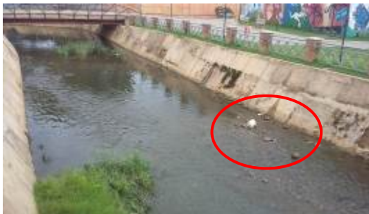
Figura 8. Canal de drenagem assoreado com resíduos sólidos. Fonte: Autor.
