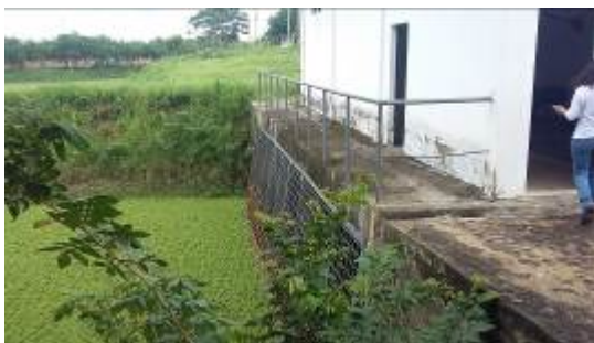
Figura 21. Gradeamento de proteção das bombas da estação elevatória do bairro Mocambinho, próximo a rua Santa Clara. Fonte: Autor.
