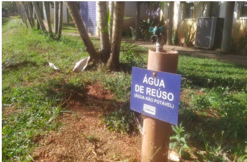
Figura 7: Reúso interno para o sistema de jardinagem da ETE I.
