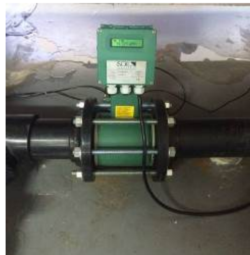
(d) – Medidor eletromagnético instalado no canal de alvenaria
