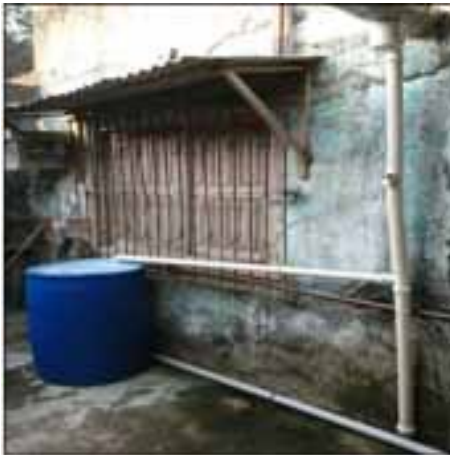
Figura 5: Sistema de captação.
