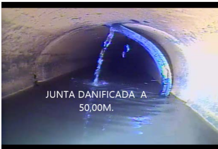
Figura 1 – Junta danificada - Fonte: Sabesp (2016)
