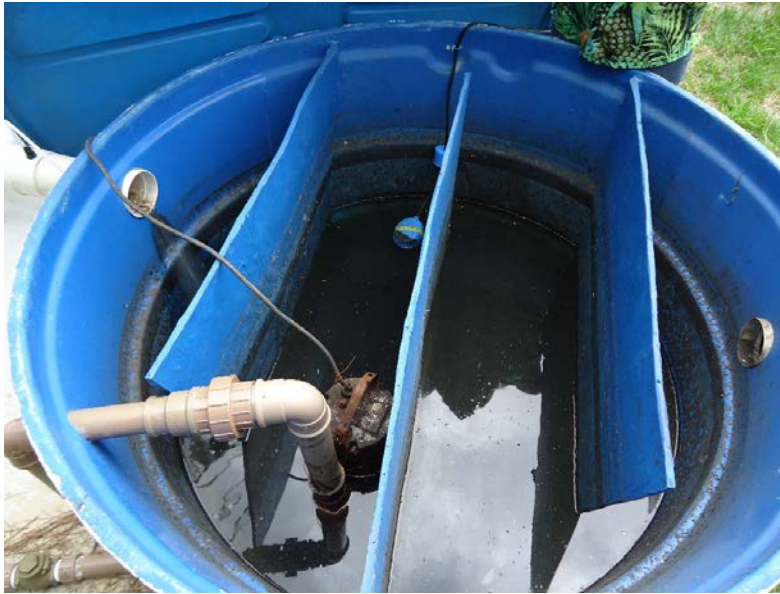
Figura 4: Sistema de desinfecção da ETE Litoral Norte, mostrando as chicanas para aumentar o tempo de residência do efluente.
