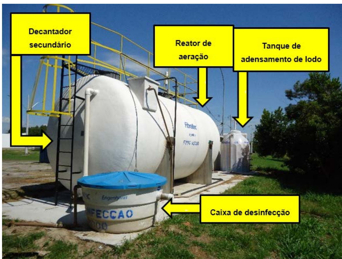
Figura 2: Fotografia da ETE do Campus Litoral Norte da UFRGS mostrando algumas etapas do tratamento que o efluente recebe.
